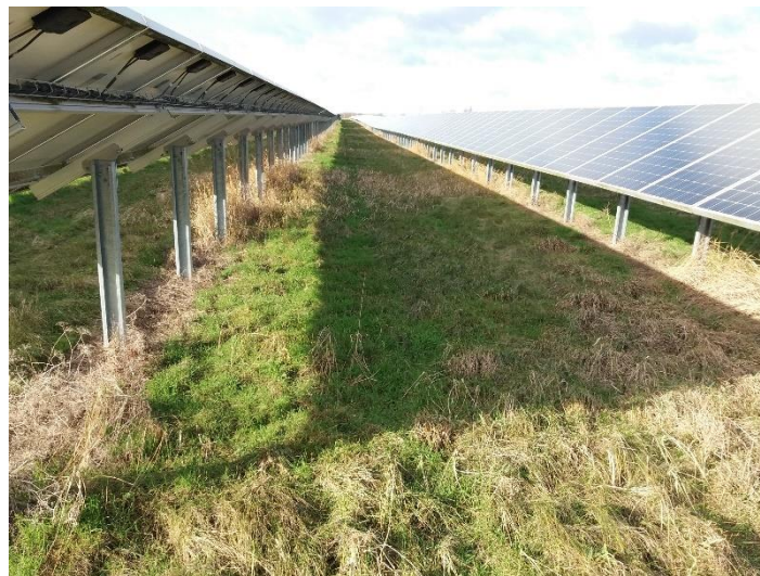
Abbildung 5: Aufnahme einer Freiflächenanlage auf einer Grasfläche - Quelle: Eigene Aufnahme
